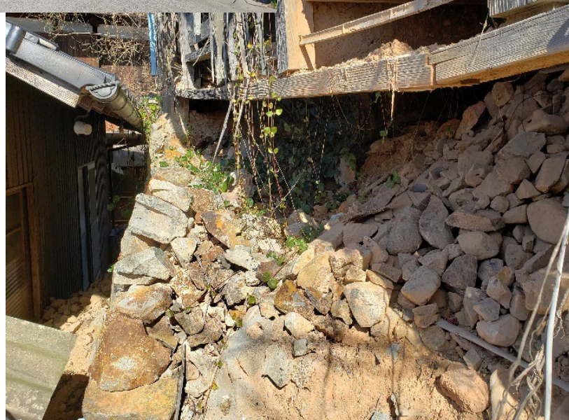
石垣上の家屋が傾いて危険な状態2021/2
